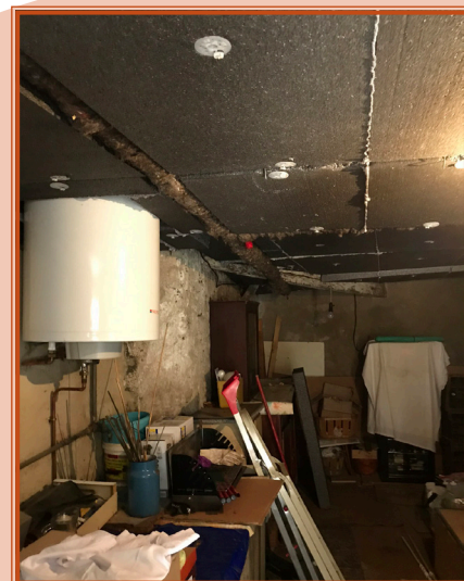
Des logements insalubres
